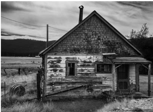
02 - Abandoned Cabin Sierraville CA.jpg
